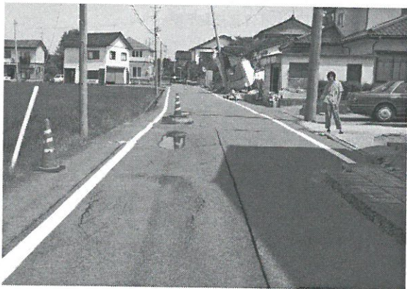
写真 5.9.2-2 茨目地区で浮き上がったマンホール
