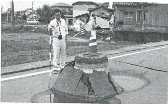
写真 5.9.2-1 柏崎市長崎地区で浮き上がったマンホール
