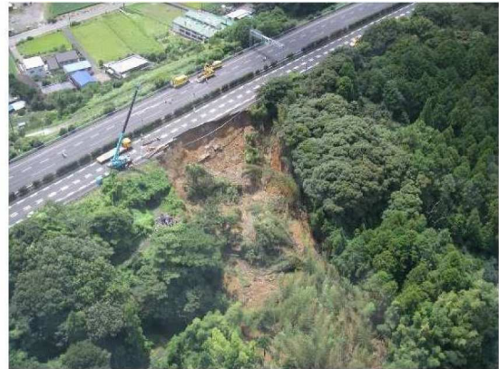
写真-1 盛土のり面の崩落状況
