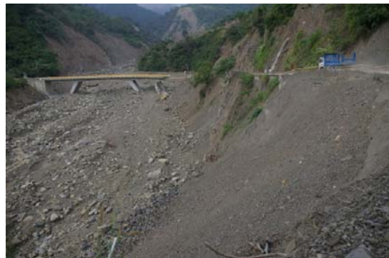
写真-3.27 翠谷橋の被災状況(上流側向きに撮影)
