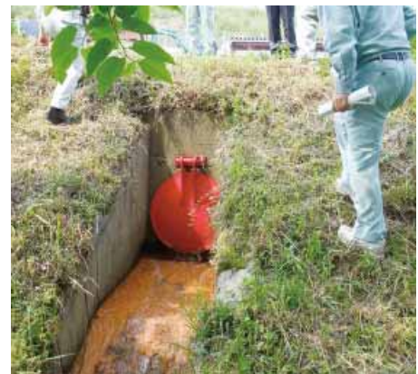
写真-2 2007年新潟県中越沖地震で被災した地区に設置した排水管で集めた地下水を川に自然流下させている状況
