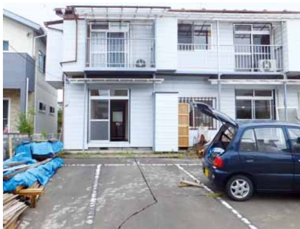
写真-7 切盛境界の段差による被害事例
