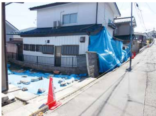
写真-4 1978年宮城県沖地震で被災した後に抑止杭と集水ボーリングで滑動崩落対策をしていた宅地で東日本大震災の際に発生した変状
