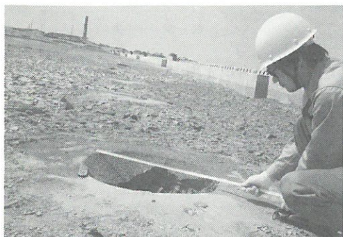
写真4.79 エプロン未舗装部に点在する噴砂 (向浜3号(-10m)岸壁)
