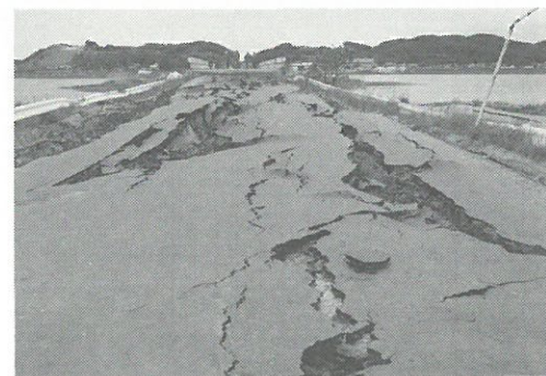
写真 4.65 五明光橋被害 (取付道路の破壊)
