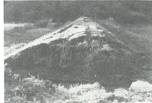
写真4.84 「一の沢」決壊部
