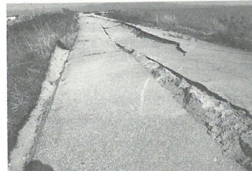
写真 4.54(c) 東部承水路堤防 ECR 18+100 付近の変状
