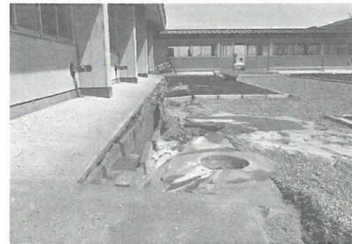
写真 4.51 男鹿工業高校の液状化発生状況 35)
