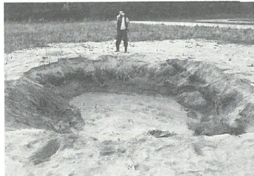
写真 4.34 車力村富苑西方にある車力村農村広場付近の休耕田内に発生した直径7 mの巨大噴砂孔
