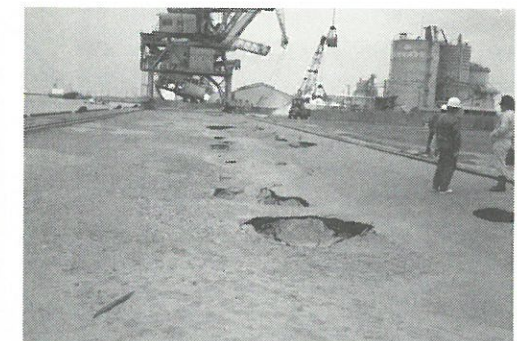
写真4.78 エプロン上の噴砂と陥没 [中島2号(-10m)岸壁]
