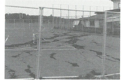
写真4.13 県立男鹿工業高校テニスコートの亀裂とその脇にある宅地の盛土崩壊による家屋被害
