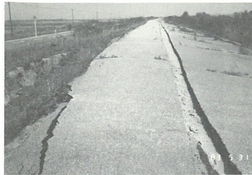
写真 4.54(a) 東部承水路堤防 ECR 8+100 付近の変状
