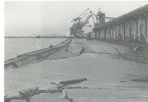
写真4.6 秋田港中島1号岸壁の陥没と護岸のはらみ出し
