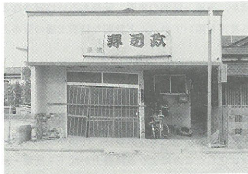
写真4.4 新屋元町の液状化で傾斜した家屋
