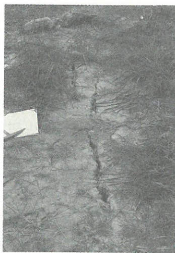
写真 4.86 「外の沢」天端の軸方向クラック
