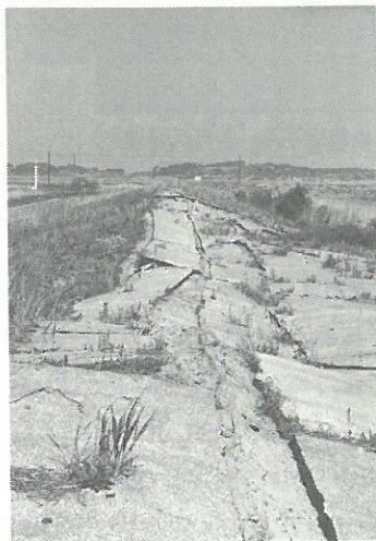
写真4.15 東部承水路北部の堤防崩壊
