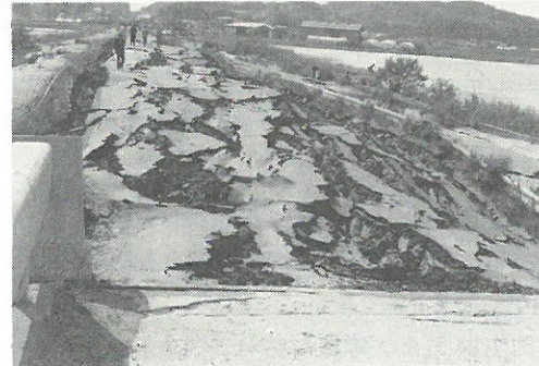
写真 4.55 五明光橋西方取付道路の変状
