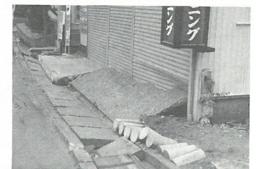
写真 4.26 能代市河戸川前山地区における道路側溝の破壊
