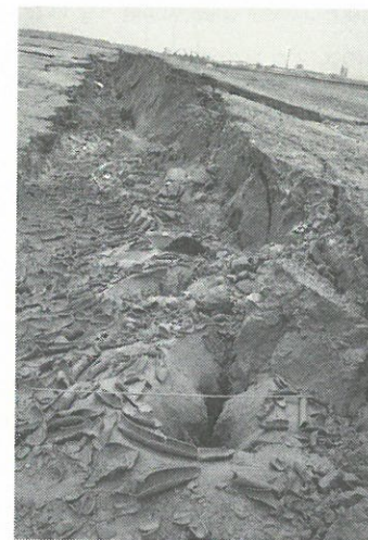
写真4.77 アンカー工の浮上がり と噴砂(外港地区護岸)
