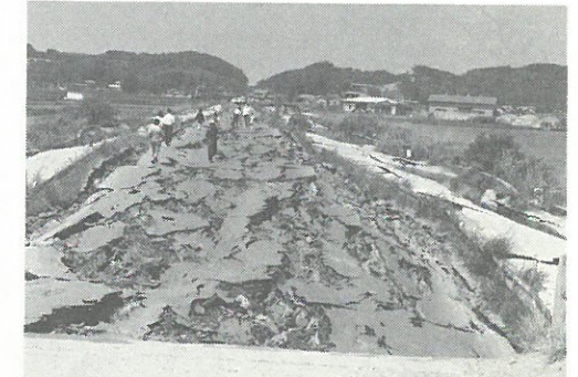
写真4.20 五明光橋若美町側取付け道路の破壊
