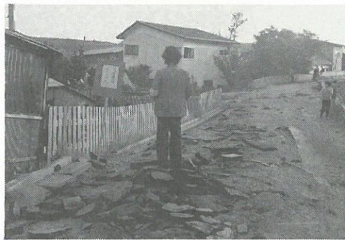
写真 4.37 車力村富苑山の上地区における舗装道路の破壊
