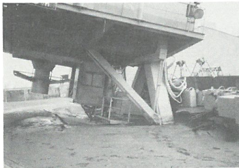
写真4.8 秋田港中島2号岸壁にある荷揚用機械(アンローダー)の片脚が折損し、噴砂の中に埋没 (東京工業大学 福原正志氏撮影)
