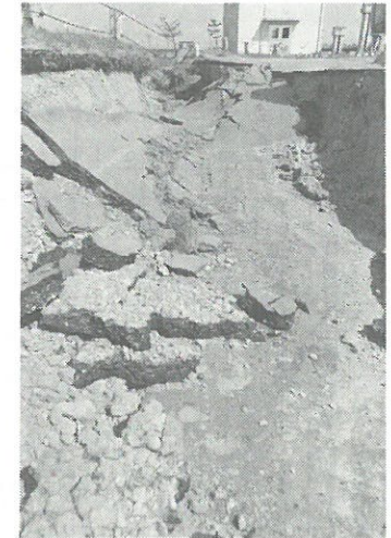
写真 4.64 八郎湖岸橋被害 (取付け道路の陥没)
