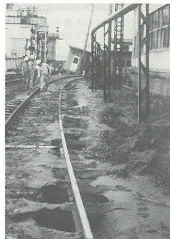
写真4.46 青森駅構内で発生した噴砂(基礎地盤コンサルタンツ撮影)
