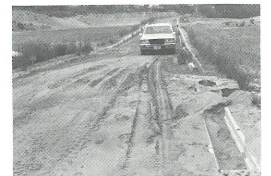
写真 4.76 ボーリング No. 8 (牛潟地区) 付近の噴砂状況
