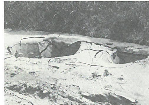
写真4.19 大潟橋南方における道路側溝での噴砂
