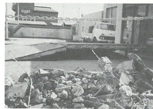
写真 4.25 能代市河戸川地区にあるガソリンスタンドの地下タンクが 70 cm 浮上 (東京工業大学 福原 正志氏撮影)
