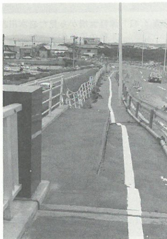
写真4.44 市浦村十三にある十三湖大橋取付け道路の被害
