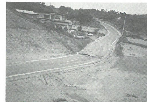
写真 4.73 ボーリング No. 1 (富菴地区) 付近の陥没状況
