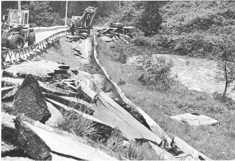
県道今別-蟹田線小国峠付近 盛土の崩壊
