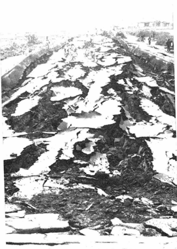
男鹿街道と八郎湯を結ぶ 五明光橋の取り付け部 における大崩壊
