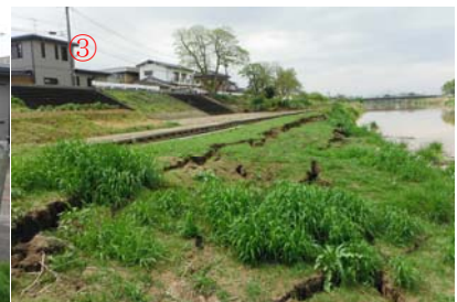
写真14 間島団地における川岸のすべり
