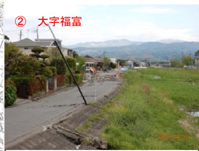
写真16 益城町福富における護岸の孕み出しと背後の宅地
