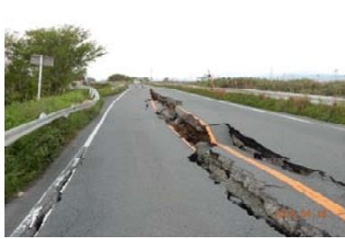
写真3 緑川右岸 8.8k 付近の堤防の被災状況
