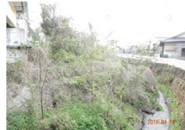
写真5 九州自動車道の盛土の崩れ
