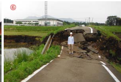
写真 24 地点⑥における陥没状況
