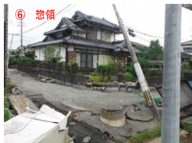
写真18 益城町惣領における液状化被害状況
