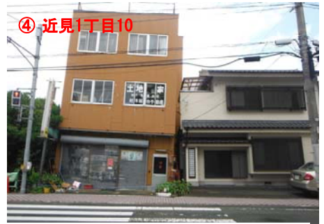
写真10 近見1丁目における液状化被害(その2)
