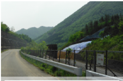
写真6 大分自動車道切り取り法面のすべり
