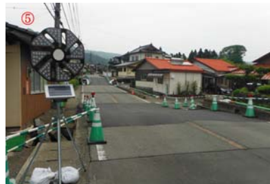
写真 23 地点⑤における陥没状況
