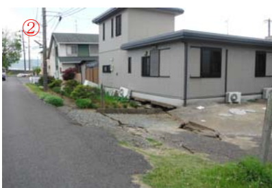
写真13 間島団地における液状化による戸建て住宅の被害
