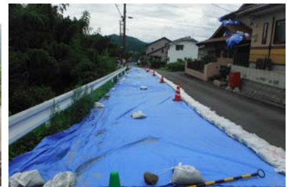
写真2 造成宅地盛土の変状した斜面の大崩壊
