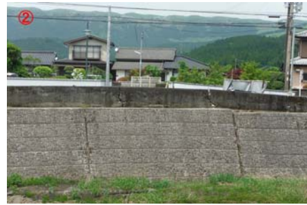
写真 21 地点②における護岸の被災状況
