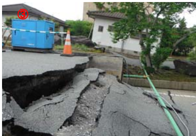
写真 22 地点③における陥没と建物傾斜状況
