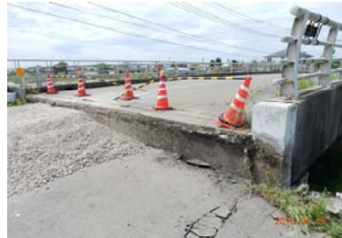
写真7 橋梁取付け部の段差
