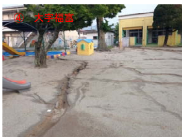
写真17 益城町福富の保育園での液状化発生状況
