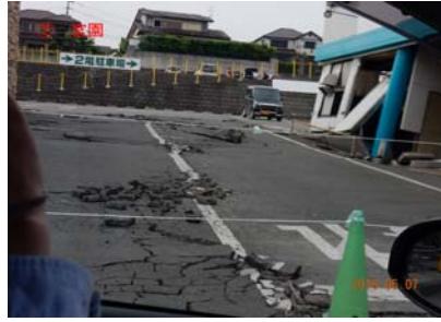
写真19 益城町地点⑦において発生したクラック
