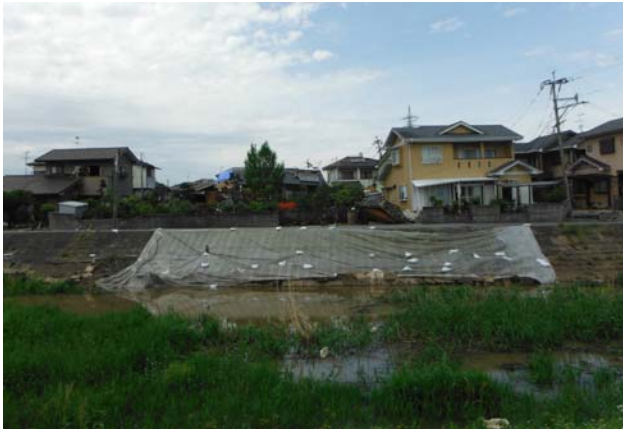
秋津川護岸(益城町)
