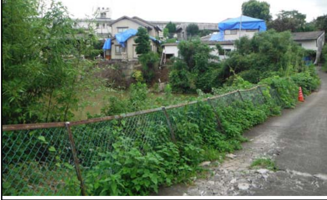
丘陵地の造成宅地盛土の変状による住宅の被害 御船町高木
