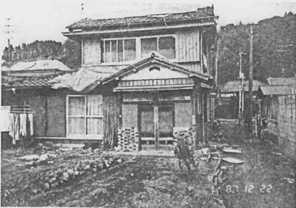
写真1 屋根瓦の被害例 (山武郡成東町)
