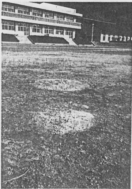
写真10 長南中学校のグラウンド (造成盛土) での噴砂
