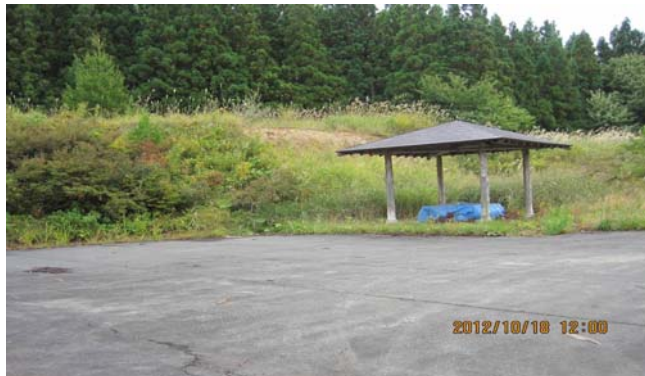
写真1 小規模造成地に伴う被害例
