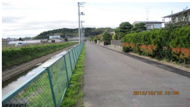
写真3 用水路沿いの被害例
