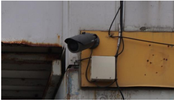
(a) 監視カメラの設置状況例 (Camera No.2)
