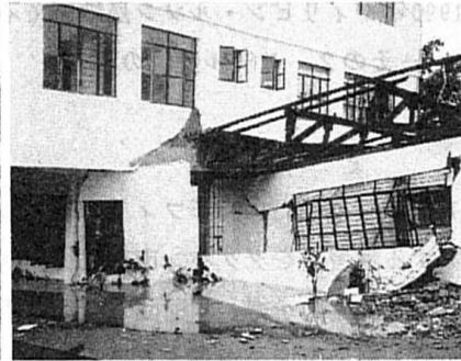
写真-3 低層部の被害
